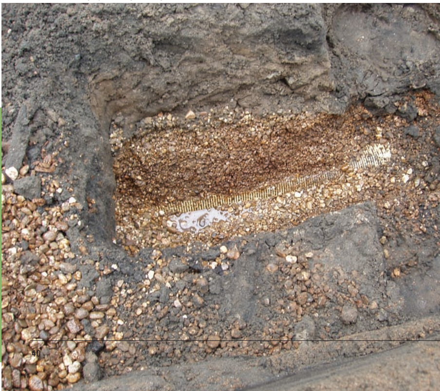
■ IJzerafzetting op drainageleiding.
