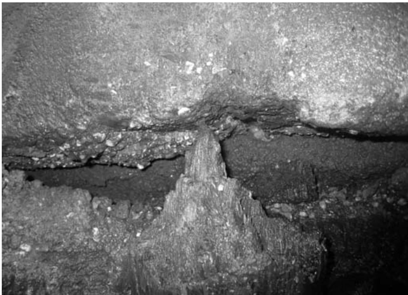
Foto 3. Houtrot van funderingspalen. Houten paalfunderingen uit de vorige eeuw komen in de problemen bij een verdere peilverlaging.
