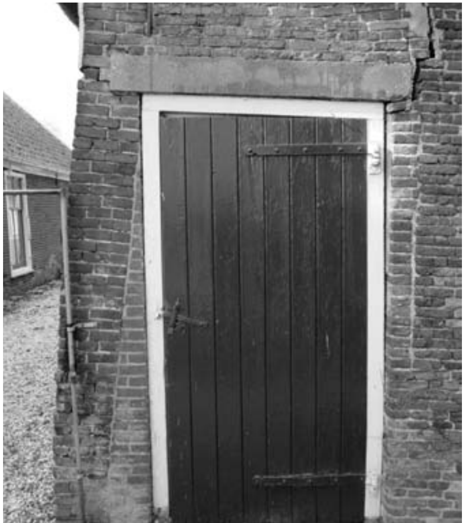
Foto 1. Peilverlaging kan met name bij oudere panden tot aanzienlijke schade leiden.
