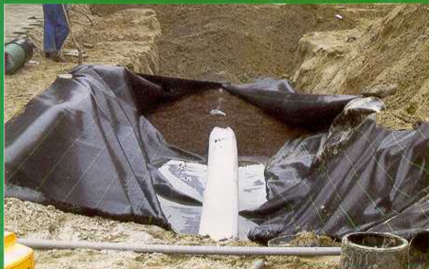
De bergingskoffer, bestaande uit argexkorrels omhuld met een waterdoorlatend geotextiel.
