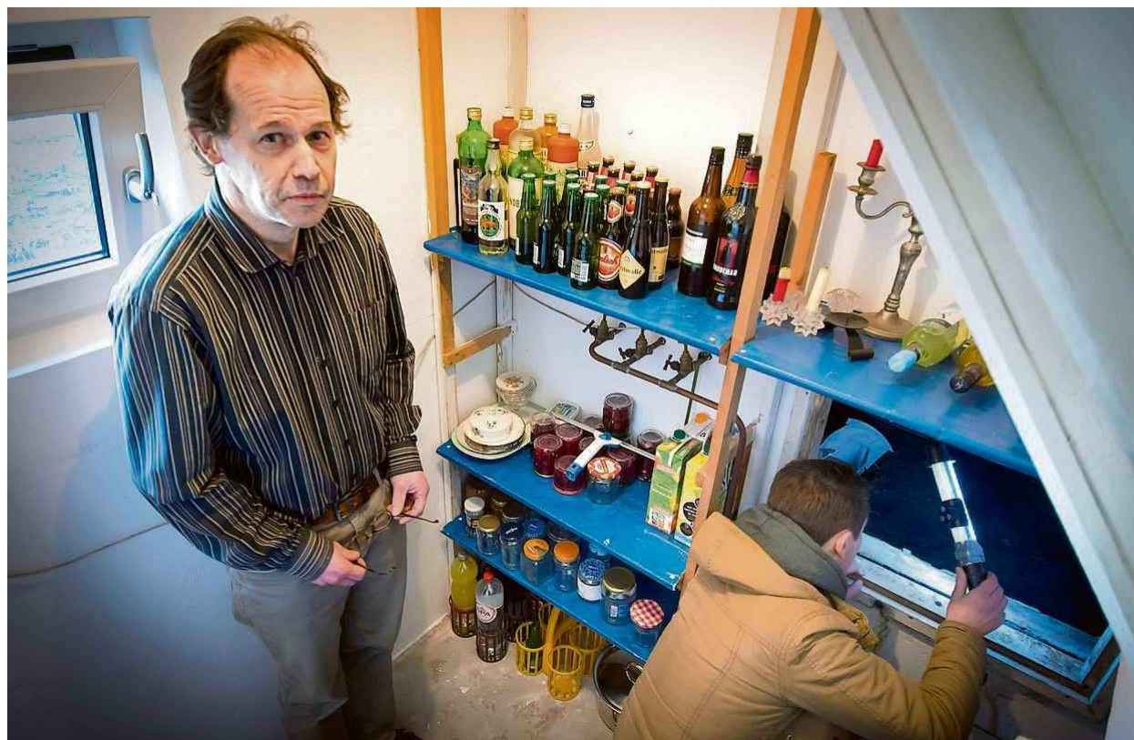
Inwoner Theo Veenker (links) baalt van de vochtproblemen in de kruipruimte van zijn huis. Laurens Kaland van ingenieursbureau Wareco onderzoekt de problemen vanuit de kelder. FOTO JAN ANNINGA
