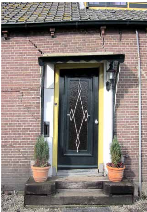
Schade door te lage grondwaterstand.
